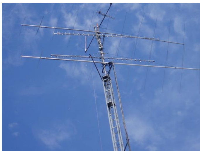
組みあがり、上が 27m、下が 23.5m に取り付けられています。間に 430MHz 用 25ele × 2 がはさまれています。
