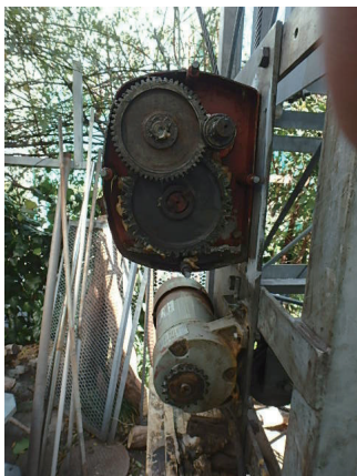
ギヤボックスの内部、上部の大きなギヤの中心線近くまで水が溜まっていた形跡がありました。これは想定外。
