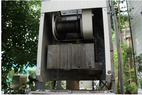
巻き上げ機のカバーを外した所 下がギヤードモーター上が減速機とドラム
